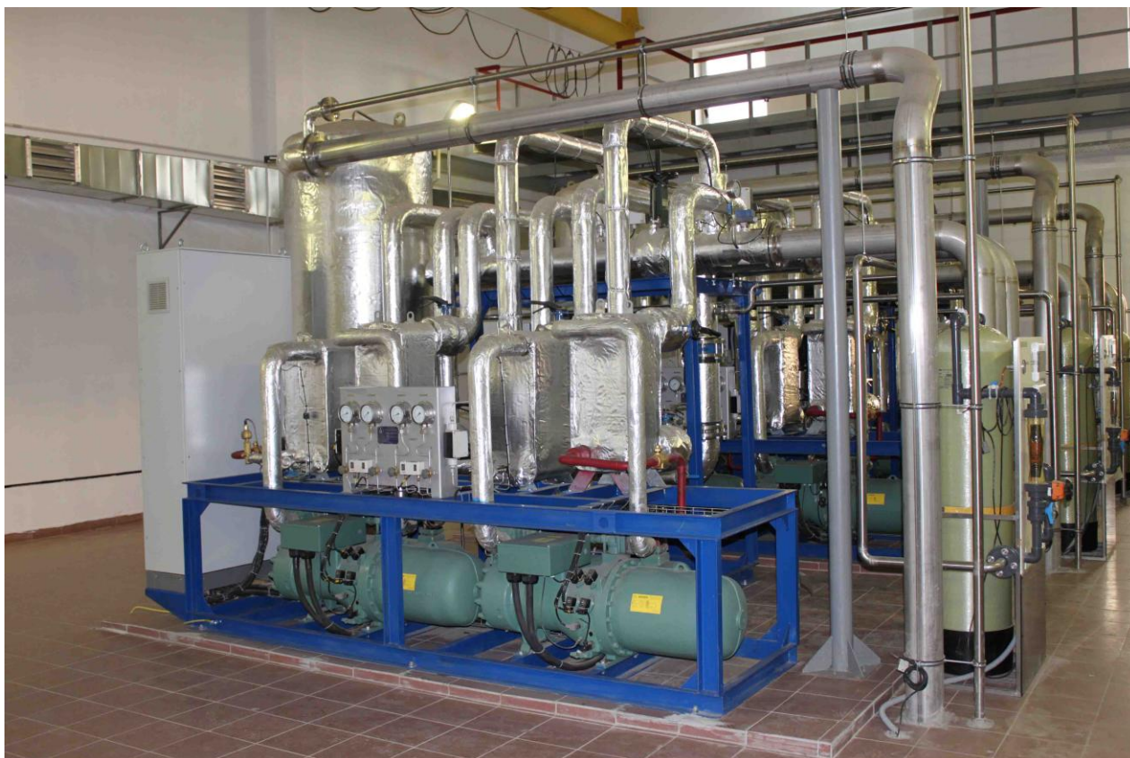
Рис.6 Оборудование блоков водяного охлаждения
